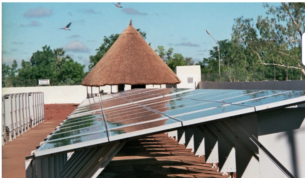
Centrale photovoltaïque de Kimparana (Mali).
